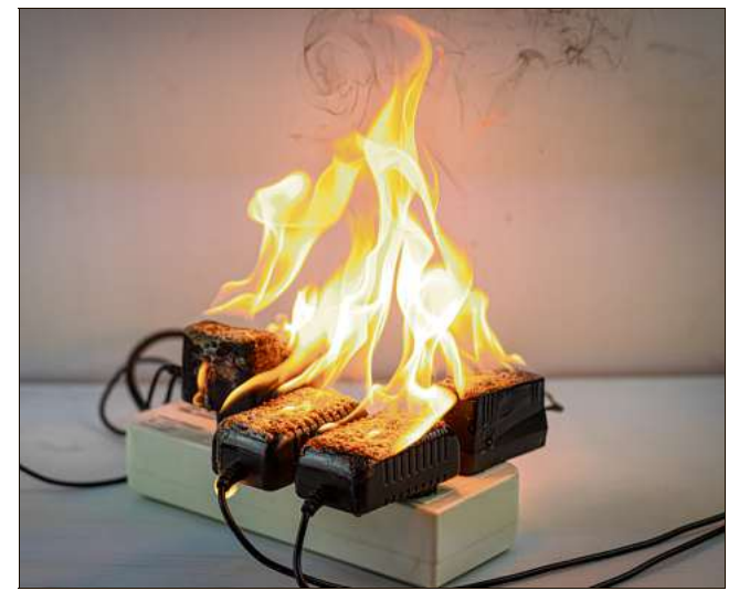
Mehrfachsteckdosen können überhitzen und im schlimmsten Fall Feuer fangen.
